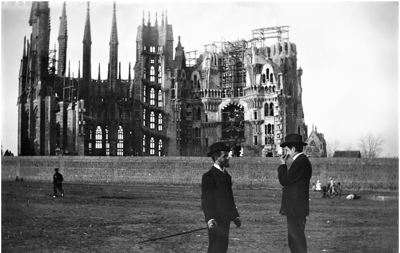
Sagrada Família under construction, 1905 – Author, Baldomer Gili i Roig, Museu d'Art Jaume Morera, Public domain, Wikimedia
